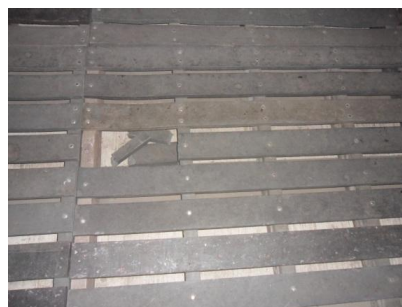
Foto 14. Estiba en mal estado
