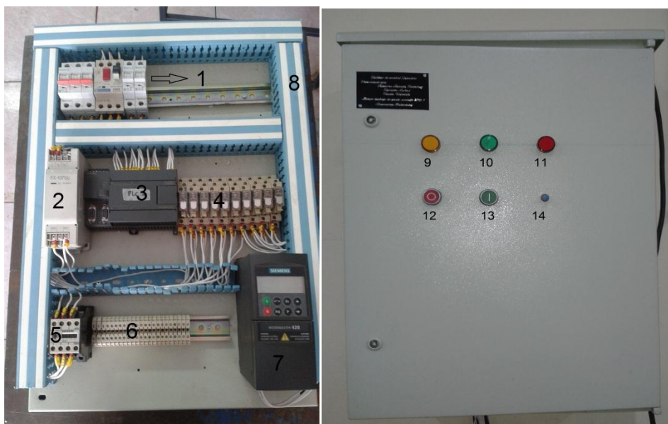
Imagen 22. Tablero de Control Implementado
