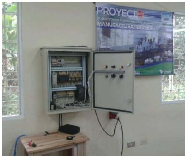
Imagen 28. Posicionamiento del tablero de control
