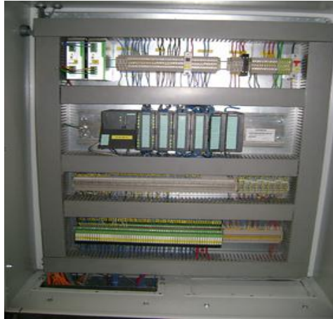
Imagen 9. Tablero de Control Estándar
