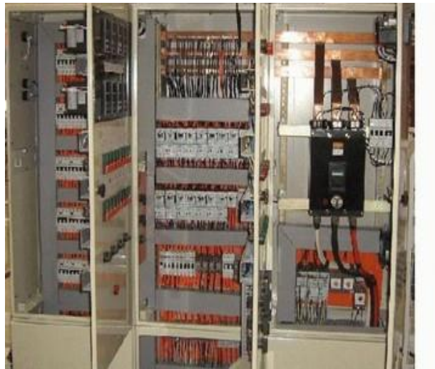
Imagen 8. Tablero de Control Robusto
