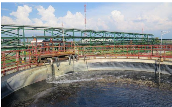
Fotografía 10. Tanque de igualación
