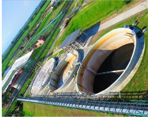
Fotografía 6. Planta de control ambiental
