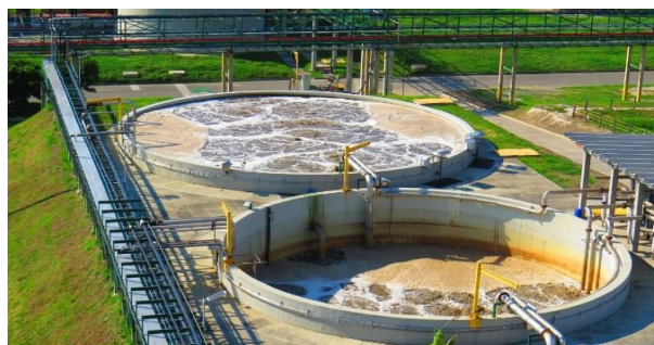
Fotografía 11. Unidades de tratamiento aerobio SBR's
