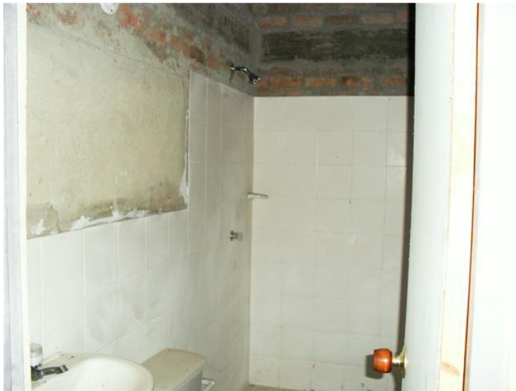
Los materiales utilizados son de mala calidad
