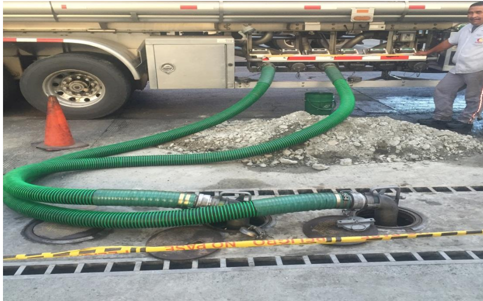
Fuente: Estación de servicio Terpel Andalucía 2
