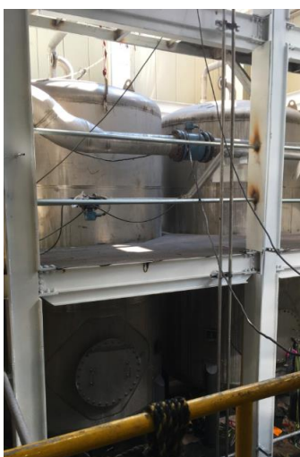
Figura 6. Tanque de meladura cruda filtrada
