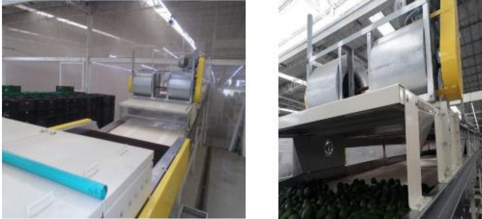
Figura 3. Cabina de aspersión
