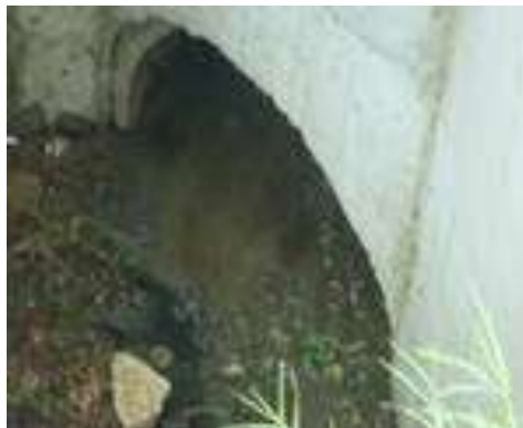
Foto. 7 Vertimiento de aguas servidas a la quebrada la Rivera
