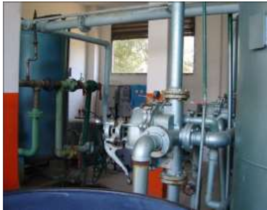
Foto 13. Sistema de válvulas del PTAP
