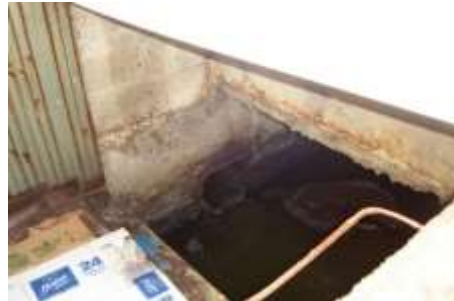
Foto 1. Vertimiento de agua residual no tratada
