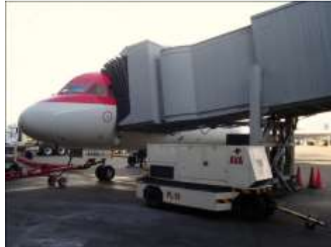
Foto 7. Suministro de corriente eléctrica
