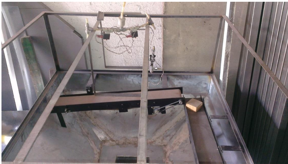
Figura 42. Instalación de electroválvulas para control de aire
