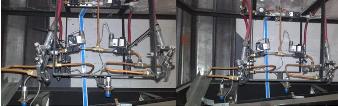
Figura 79 Electroválvulas de control de pintura y aire.
