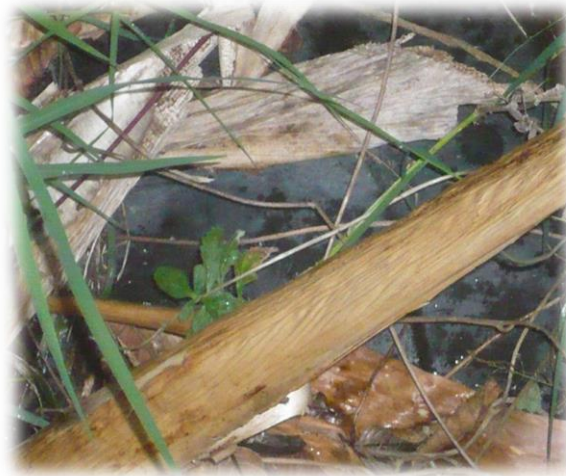
Foto 6. Estado del pozo séptico
